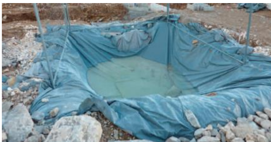
Figure 26 : Exemples de fosses étanches de récupération des résidus de nettoyage des goulottes des toupies béton.
